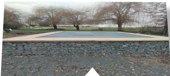
Filtres plantés de Végétaux aquatiques (FV GÉO 10 E.H)
